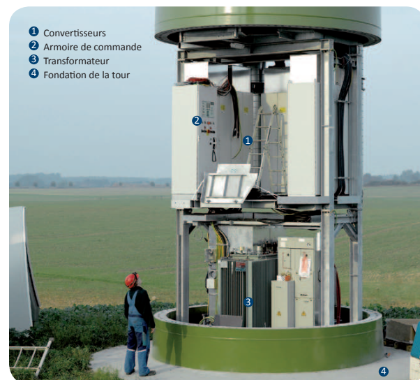
Composants électroniques dans le mât d'une éolienne
