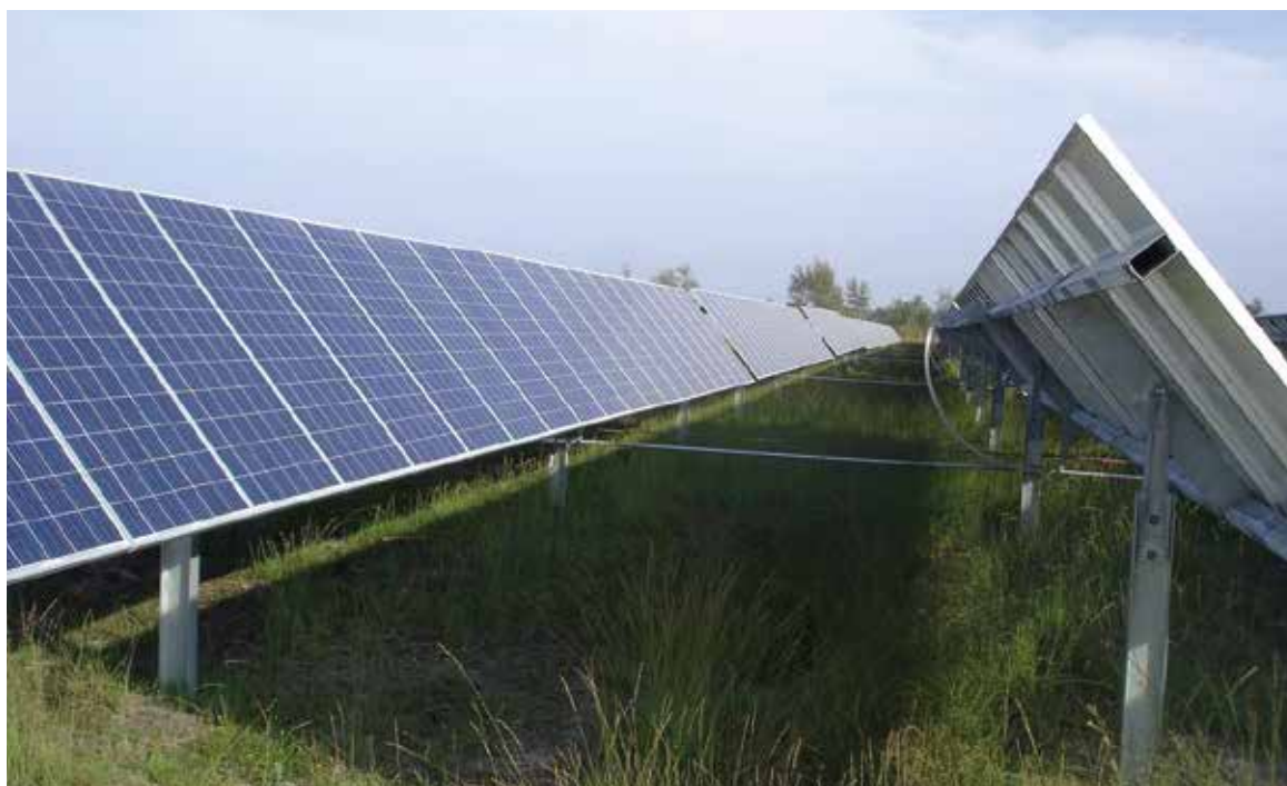
Parc solaire photovoltaïque du Bétout (33)
